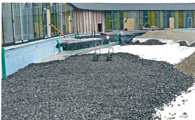
1 + 2 Im Vorfahrtshof der ADAC-Zentrale kam Glasschaumschotter zum Einsatz, um – trotz teilweise großer Aufbauhöhen – mögliche Lasten zu reduzieren.
