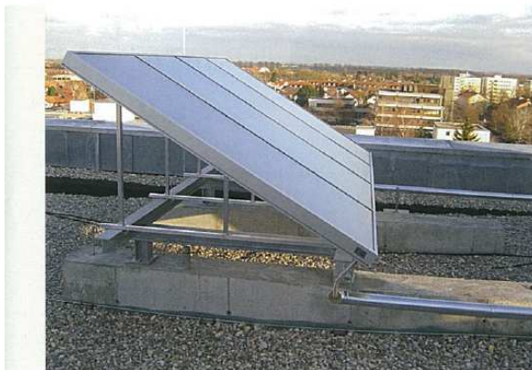
Betonfundamentstreifen halten die 125 m 2 große aufgeständerte Solaranlage.
