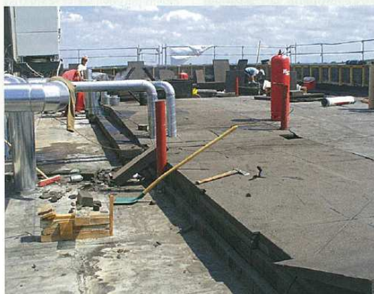
Der mehrlagig verlegte Schaumglasaufbau musste wärmebrückenfrei an die Dachdurchdringungen der Haustechnik angeschlossen werden.
