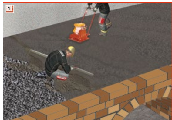
4 Vor der letzten Überfahrt mit der Rüttelplatte eine 3 cm dicke erdfeuchte Mischung aus Zementestrich / Muschelkalkestrich aufbringen und mit einrütteln.
